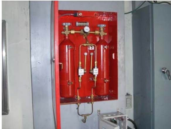
그림 5-15 Mater Control Cabinet
